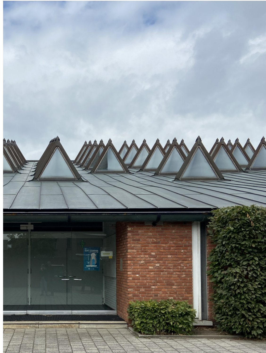
De 47 dakkoepels zijn beeldbepalend en bepalen samen met het 3D vakwerk de waarde van het dak. om te gaan.
