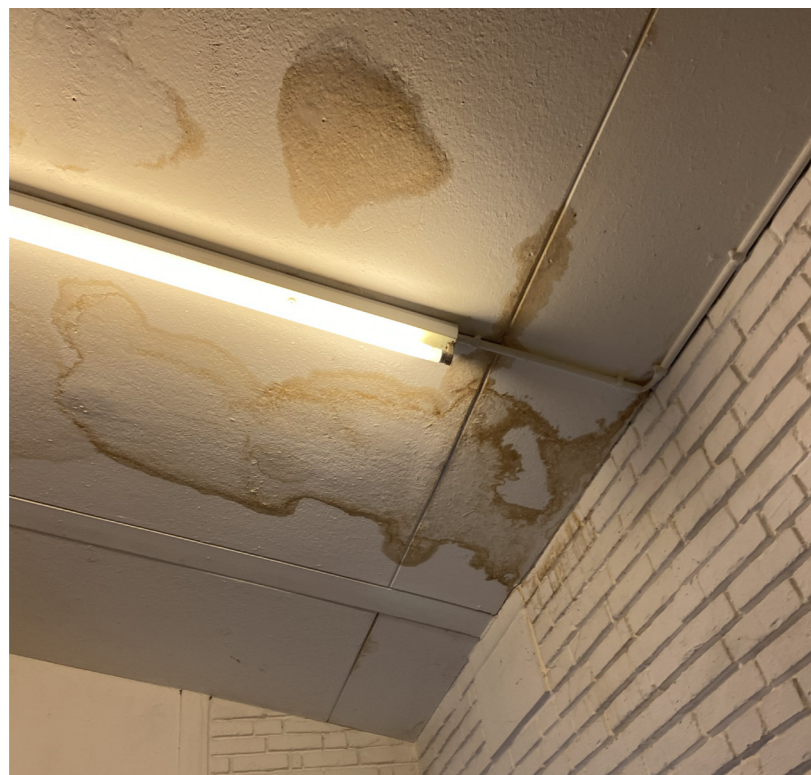
het verlaagde plafond vertoont schade door hemelwaterinfiltratie
