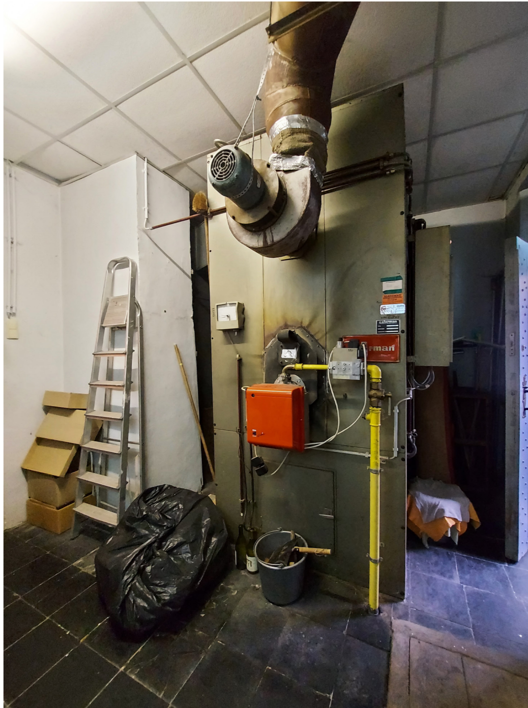
depot met verwarmingsinstallatie
