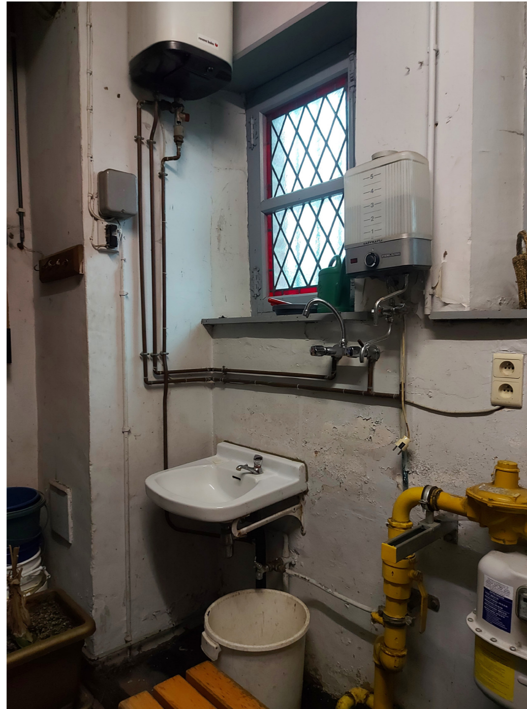
gootsteen en apparatuur in depot
