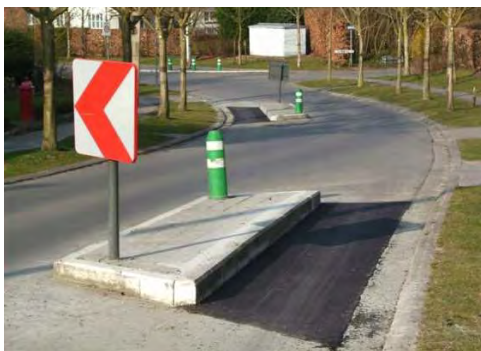
Figuur 15: Slecht voorbeeld van een asverschuiving. Door de krappe ruimte voor fietsers en bij druk verkeer kunnen fietsers in de verdrukking komen. (foto: Fietsersbond Temse)
