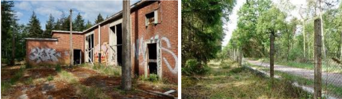
Figuur 7 Links – de militaire gebouwen zijn vernield, vervallen en bespoten met graffiti. Rechts – de omheining (cfr. Antea Group, 2022).
