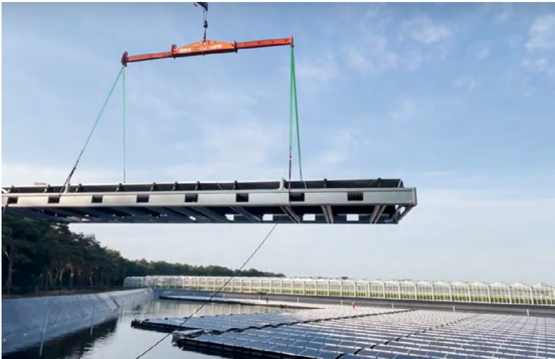
Zonnepanelen op een bufferbekken bij een glastuinbouwbedrijf. -foto: Omexom
